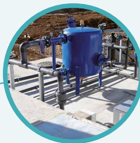
Unité de filtration du RSD
