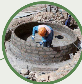
Construction du digesteur agricole à dôme hémisphérique dans le village Ait Idir.
