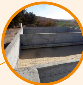
Filtre à sable construit à la station d'épuration de Médenine.
