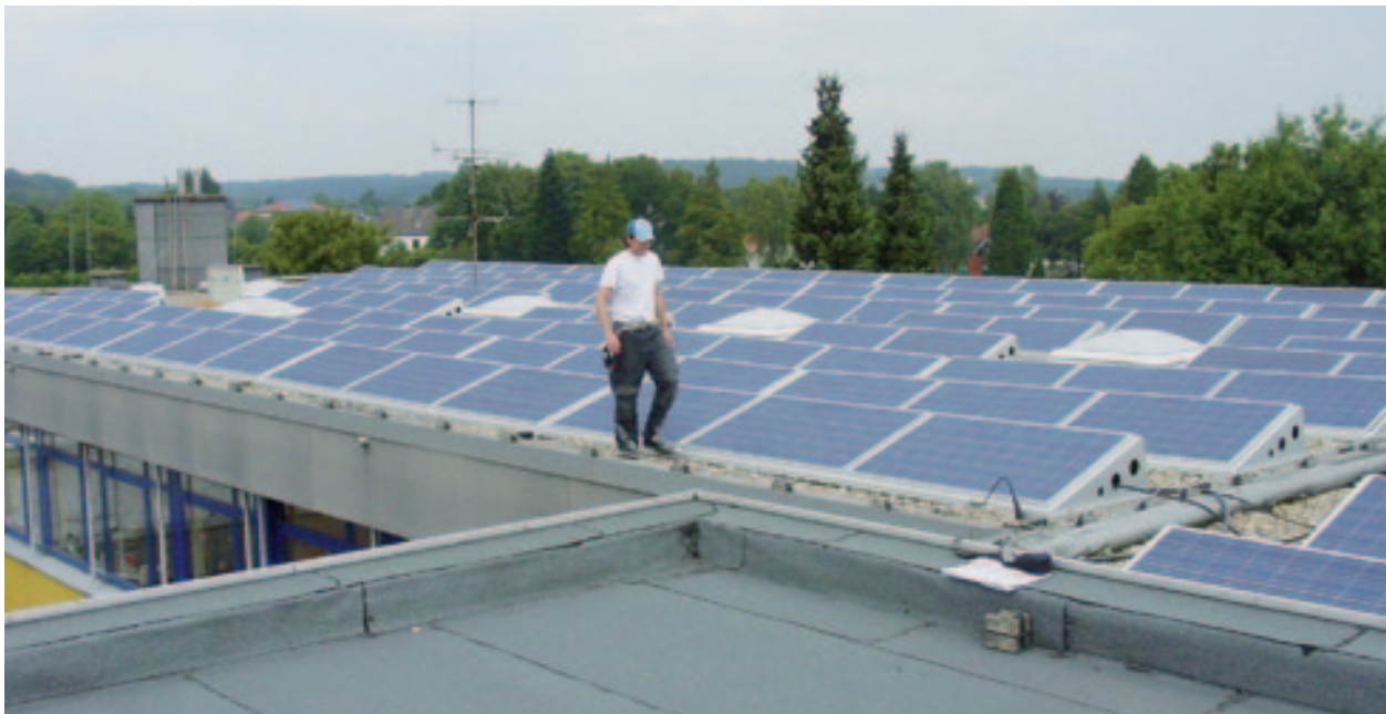
Photovoltaikanlage auf der Glückaufhalle
