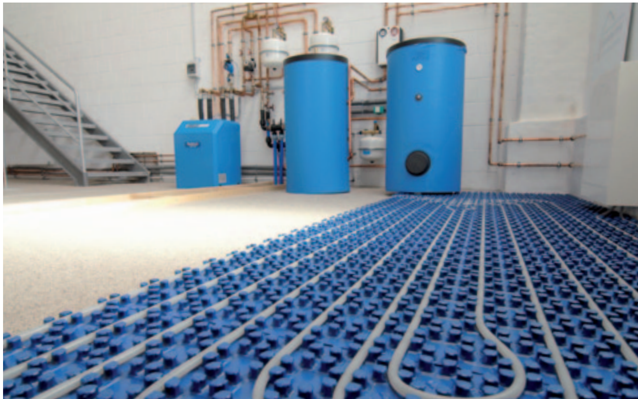
Wärmepumpenanlage im Energiezentrum
