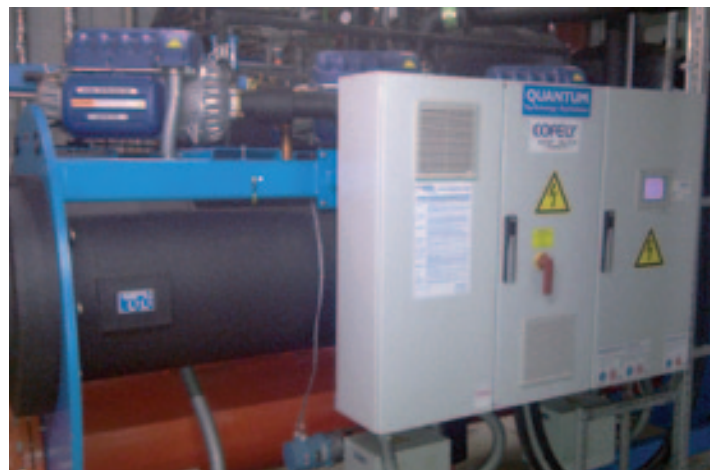
Die neue Kältekompressionsanlage eines Berliner Klinikums
